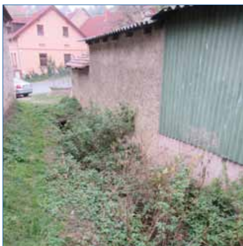
» Snímek zachycuje původní stav v části Černín. Jedná se o propojku, kterou částečně občané využívají. Problém byl zejména s přívalem vody, která zaplavovala hlavně náves. Voda se šířila do rodinných domků i pod návsí a narušovala i stavení v okolí žlabu.
