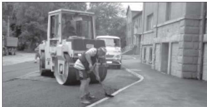
Začátkem července prováděla firma Strabag pokládku nového asfaltového povrchu nejen před nádražní budovou, ale i na příjezdové komunikaci. Nově byl opraven i chodník k nádraží. Prostor před nádražím tak získal po mnoha letech pěkný vzhled.
