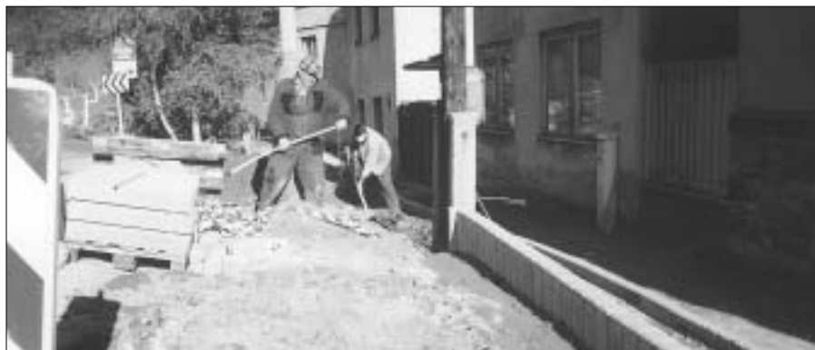
Pracovníci firmy STRABAG provedli v době 15. 9. - 20. 10. 2003 opravu chodníku a vozovky v Husově ulici. Hotové dílo se občanům Zdic líbí. Foto: - sm -
