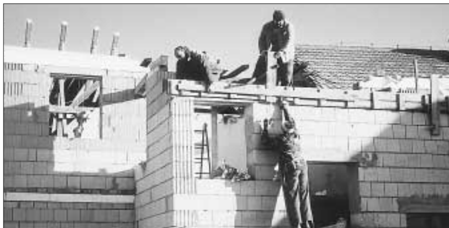
Výstavba šesti bytových jednotek v Černíně pokračuje i v zimním období. Práce provádí firma Řemesla AZ, s.r.o., Praha 5. Foto: Jana Smíšková.
